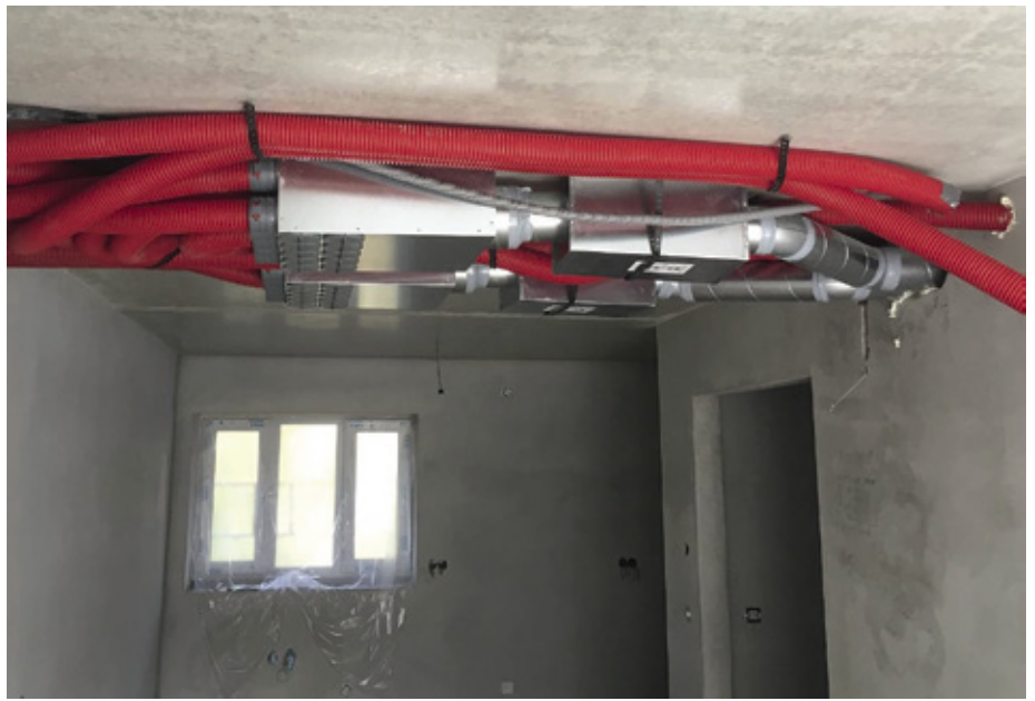
Luftkanäle wurden ab den Verteilern in Flexrohr ausgeführt. Verteiler und Schalldämpfer sind in Abkofferungen im Flurbereich untergebracht.
