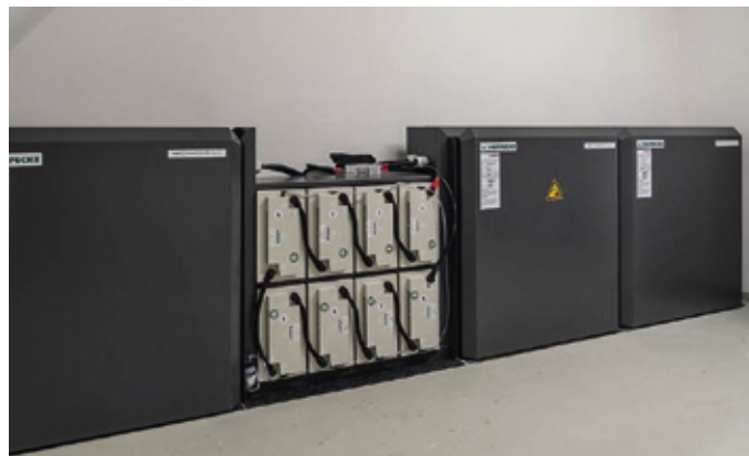
Die Speicherung des Überschussstromes erfolgt in zwei Speicherbänken à 22 \text{ kWh} mit einer Nennspannung von 48 \text{ V} und einem maximalen Entladestrom von 160 \text{ A} .
