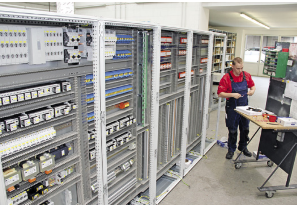
Um auf der Baustelle Zeit zu sparen, werden die Schaltschränke im Betrieb geplant, gebaut und geprüft.
