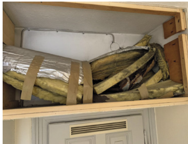
Im Zuge der Umbauarbeiten wurde entdeckt, dass die waagrecht verlaufende Abgasleitung vollends korrodiert und regelrecht abgeknickt ist.
