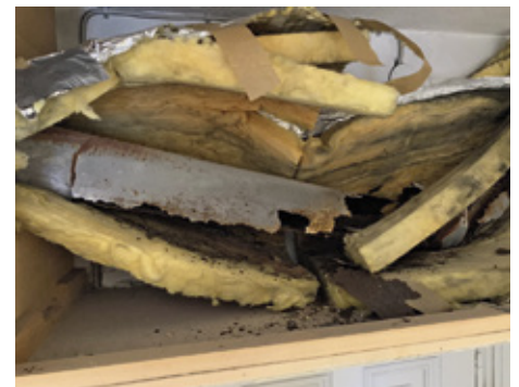
Im Detail wird der Schaden deutlich.
