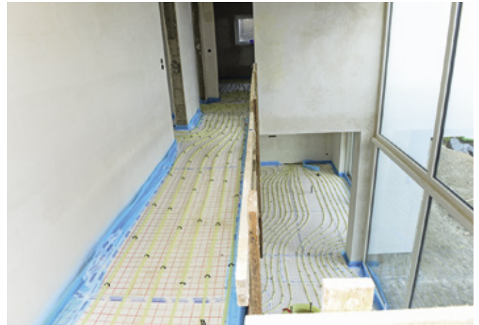
Im Erdgeschoss ist eine verstärkte Wärme-/Trittschalldämmung vorgesehen. Dort beträgt die Aufbauhöhe 20 cm, im Obergeschoss 15 cm. In die Dämmschichtebene wurden die Flachkanalrohre integriert.
