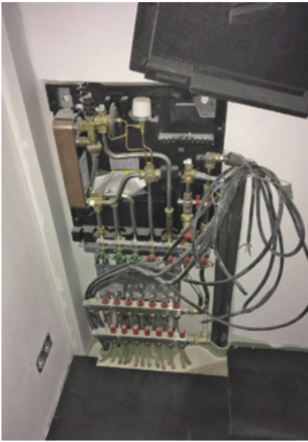
Die Warmwassererzeugung erfolgt wohnungswise über Wohnungsübergabestationen.
