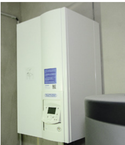
Zur Energieerzeugung für Heizung und Warmwasser wurde eine Luft/Wasser-Wärmepumpe installiert.
